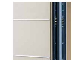
Passage de câble
