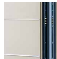
Passage de câble
