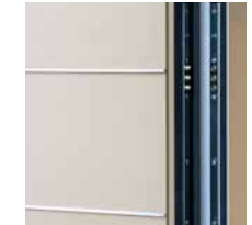
Passage de câble
